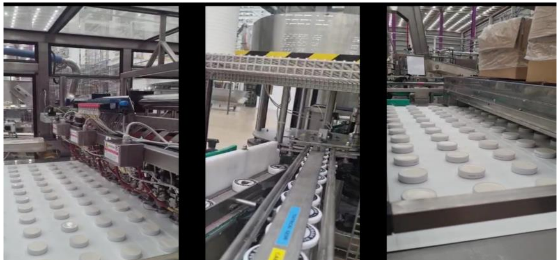
Planta de Cuidado Personal ( Línea de Manufactura Pomadas )
