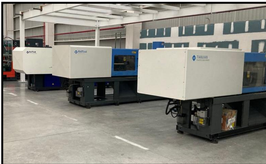
Tres líneas de inyección de plástico (Planta de Cuidado Personal)
