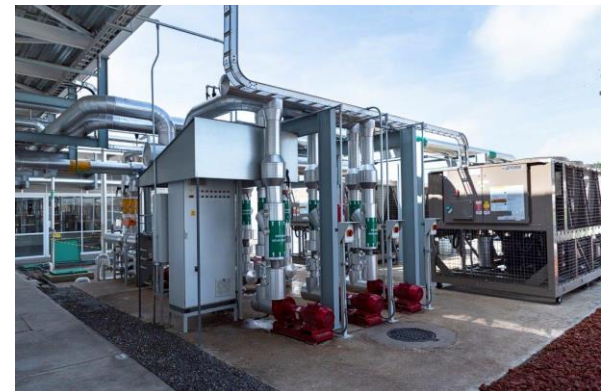
Sistema de enfriamiento de agua para planta OTC
