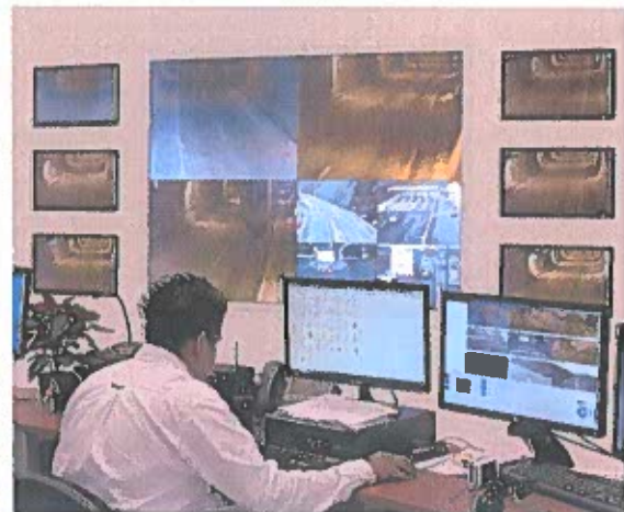
Cuarto de control de seguimiento de casetas, túneles y cámaras
